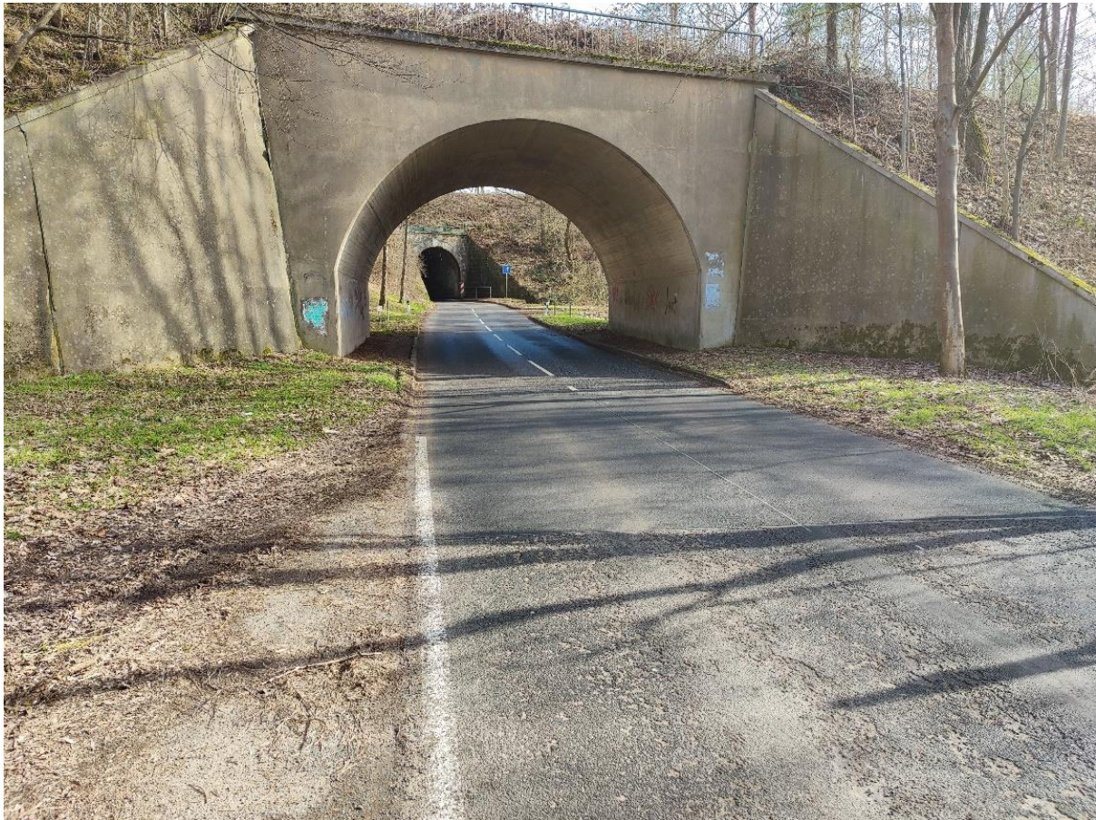
Abb. 23: K9 zwischen Meileshof und Burkhardtroda: Die beiden Bahnunterquerungen sind lediglich an die Leiteinrichtung einer stationären Anlage anzuschließen. (Aufn. 24.02.2021, F. Serfling)
