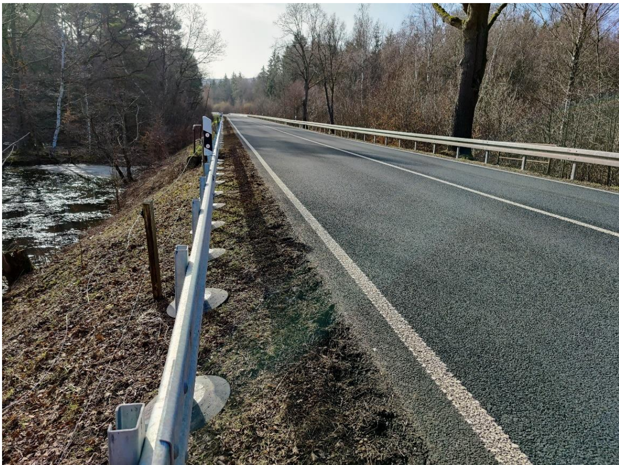
Abb. 6: B88 in Höhe Erlebachteich. Sowohl der Aufbau der mobilen Schutzanlage als auch deren Betreuung ist hier sehr problematisch. (Aufn. 24.02.2021, F. Serfling)
