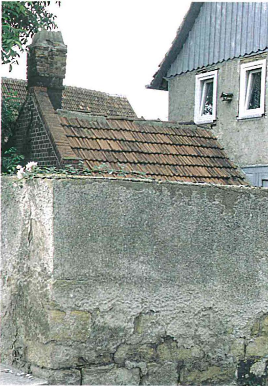
Abb. 28: Überputzte Natursteinmauer: bröckelig werdenden Putz nicht erneuern, bei Bedarf lediglich Teilbereiche verfugen, um die Statik zu erhalten. (Aufn. TH. SCHIKORA)
