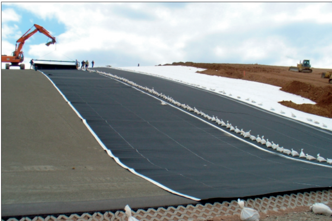
Abb. 10: Oberflächenabdichtung der Deponie Wipperoda (Lk Gotha)
