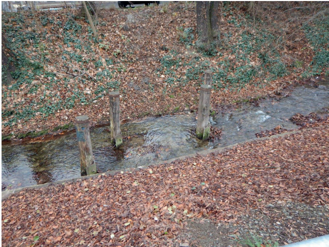
Foto 114: Treibholzsperr an einem kleinen Gewässer, die Größe ist in Abhängigkeit vom erwarteten Schwemmgut und dem höchstmöglichen Aufstau beim Bemessungsabfluss zu wählen. (Foto: M. Dittrich)
