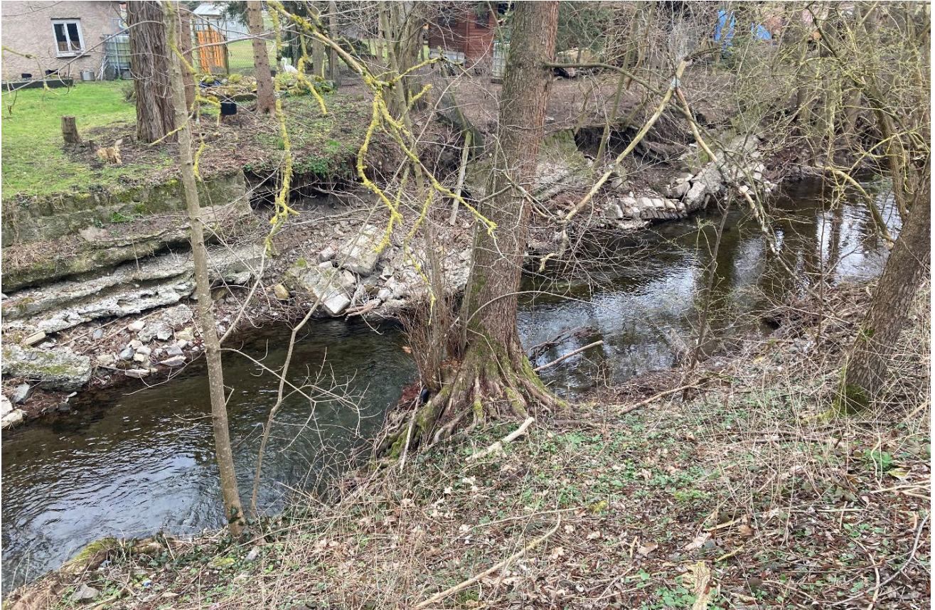
Bild 4: beschädigte Uferbefestigung mit Grundstücksverlust. (Foto: TLUBN, März 2024)
