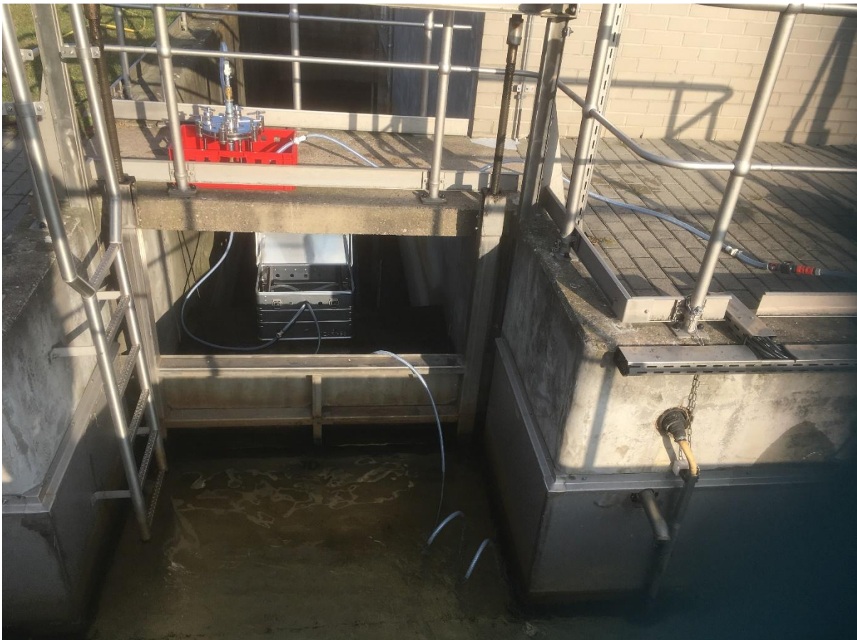
Abbildung 4: Großflächenfiltrationseinheit bei der Beprobung des Ablaufes in der Kläranlage Jena.
