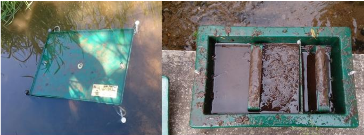
Eingebaute Schwebstofffalle im Gessenbach
