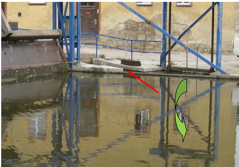
Abbildung 11: an der WKA Döbritschen oberflächennah in der Nähe des Rechens angebundene Fischabstiegsmöglichkeit (roter Pfeil); bodennahe Abstiegsmöglichkeit im Bereich des Freischusses (grüner Blockpfeil) vgl. Abbildung 12.
