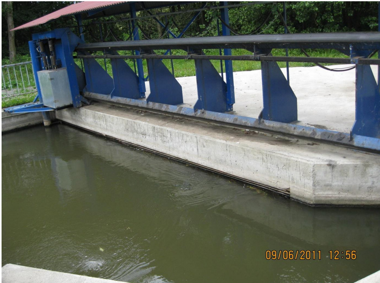
Abbildung 7: 15 mm-Horizontalrechen an der Rest-WKA in Jägersdorf
