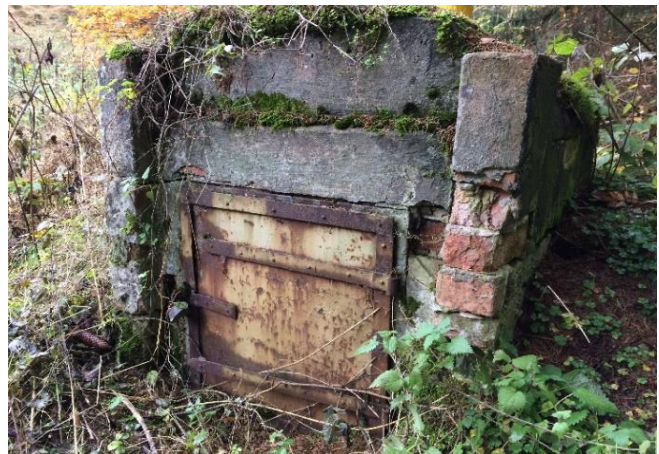
Abbildung 9: stark sanierungsbedürftige WGA
