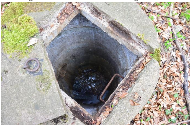
Abbildung 13: WGA mit undichter Abdeckung
