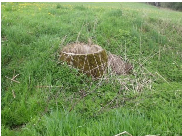
Abbildung 11: WGA mit fehlender Abdeckung
