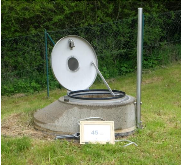
Abbildung 10: ordnungsgemäß errichteter tagwasserdichter Schacht mit Einstiegsdeckel und umlaufender Gummidichtung
